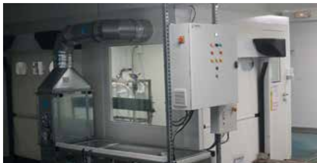
Equipement de remplissage en zone à atmosphère contrôlée ISO7
