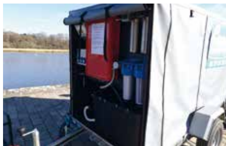
Unité de filtration mobile dans sa remorque
